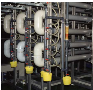
Ultrafiltration zur Abtrennung des bei der biologischen Reinigung anfallenden Schlammes
